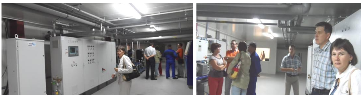
Плодохранилище хозяйства «Ровенские сады», оснащённое системами климат контроль и РГС.
